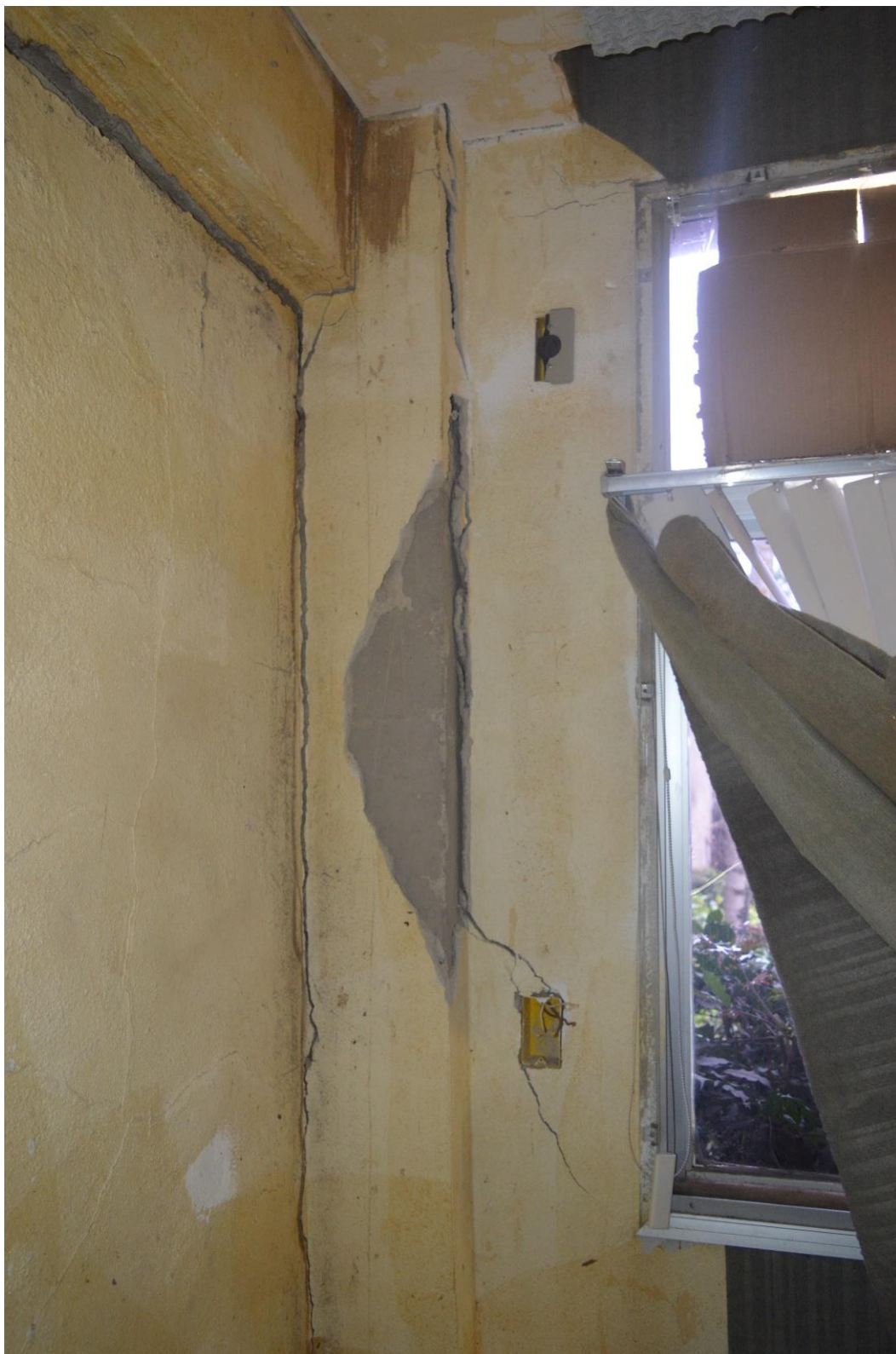
Figura 23 - Prédio Anexo - Trincas no Pilar - Descolamento da alvenaria-trincas da alvenaria – Observar que a viga apoia-se parcialmente no pilar
