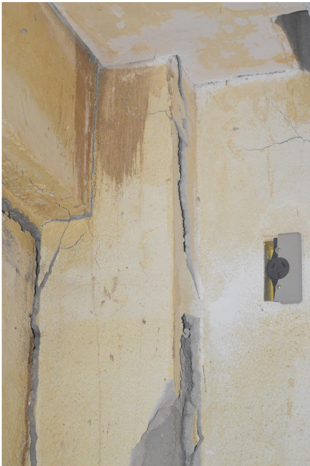
Figura 24 - Prédio Anexo - Trincas no Pilar - Descolamento da alvenaria - Ampliado
