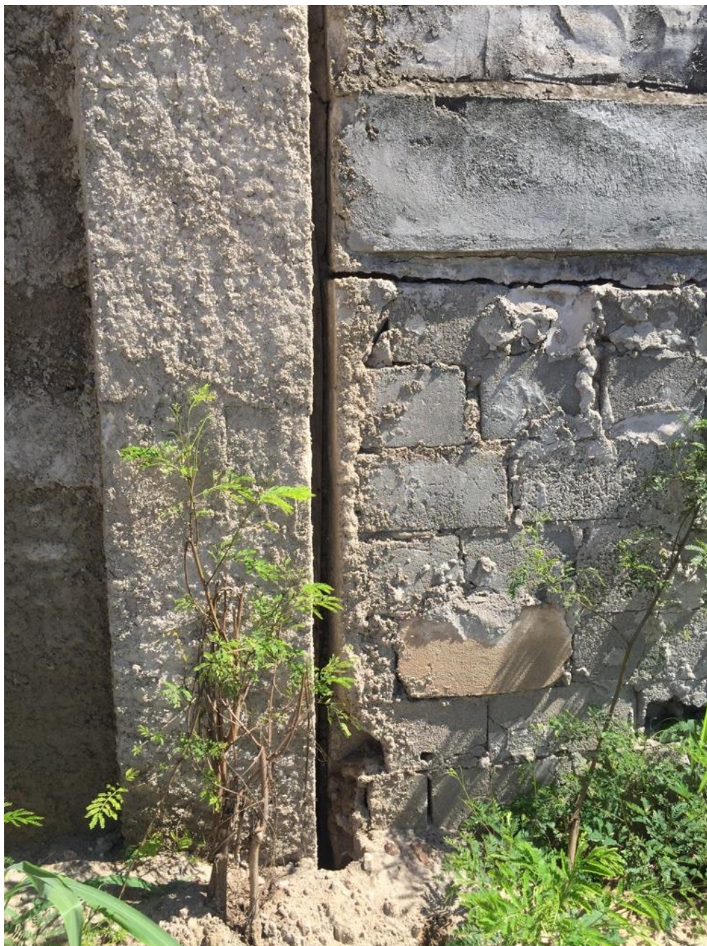
Figura 35 - Prédio Anexo - Aproximadamente 1,5 metros de aterro (areia-argilosa) solicitando a estrutura do prédio Anexo.
