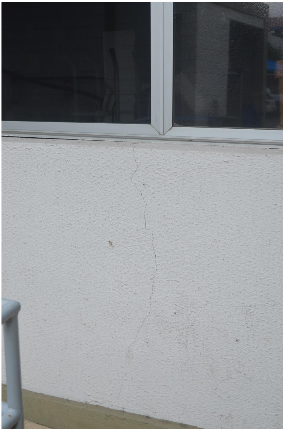
Figura 33 - Fissura Vertical na alvenaria da fachada - Detalhe Ampliado
