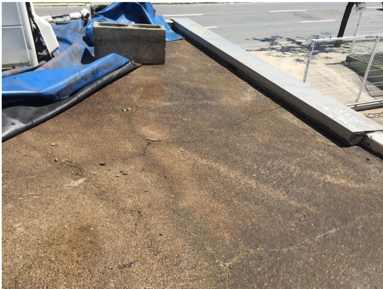
Figura 12 - Fissuras generalizadas da proteção mecânica da nova laje e da existente.
