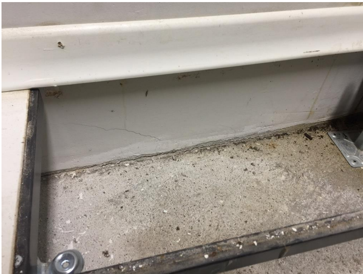
Figura 15 - Fissura na interface cinta – Laje de piso nova (radier) – Ausência de junta física com preenchimento de selante.
