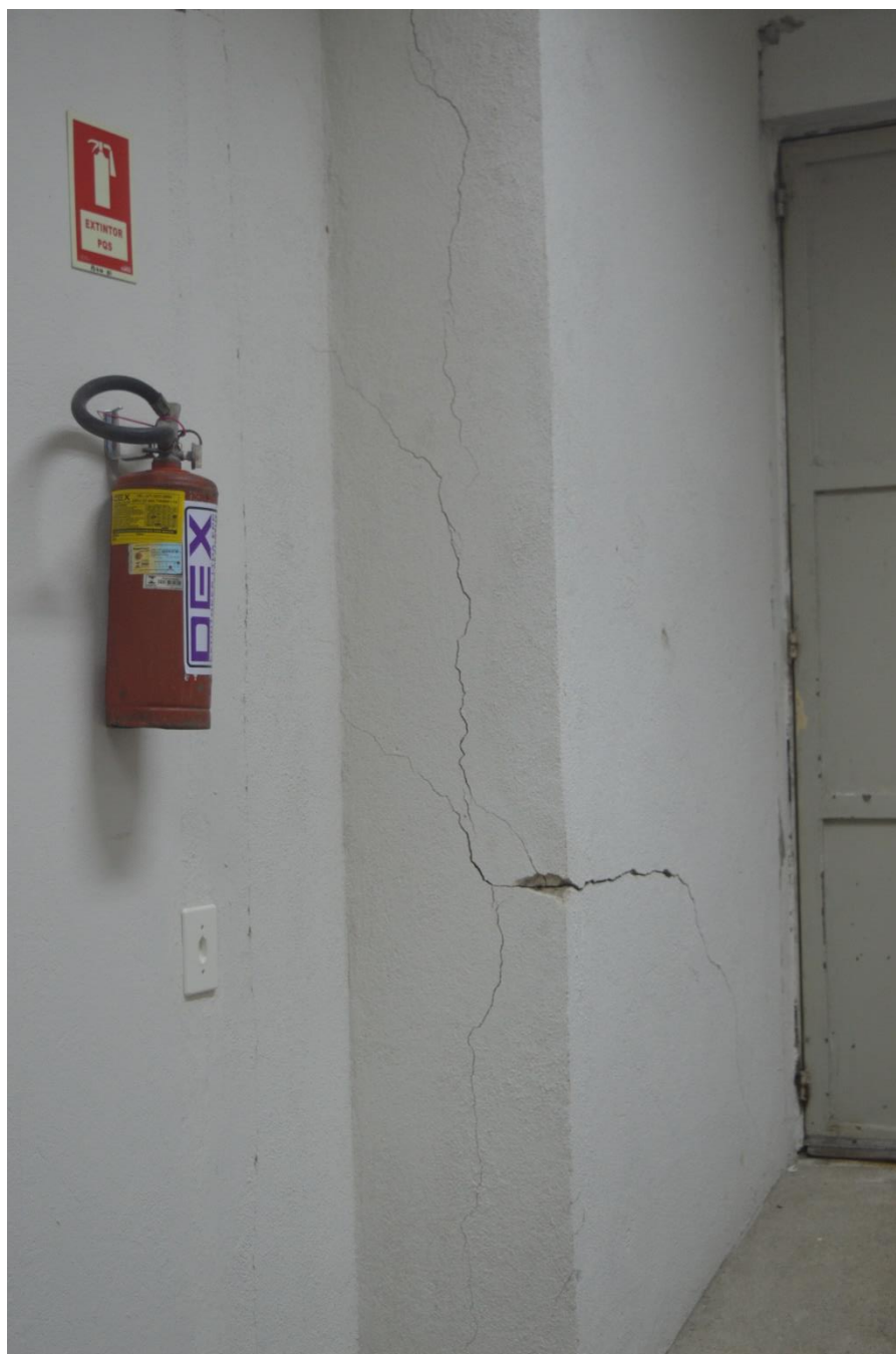
Figura 17 - Depósito Anexo - Trincas e fissuras na alvenaria
