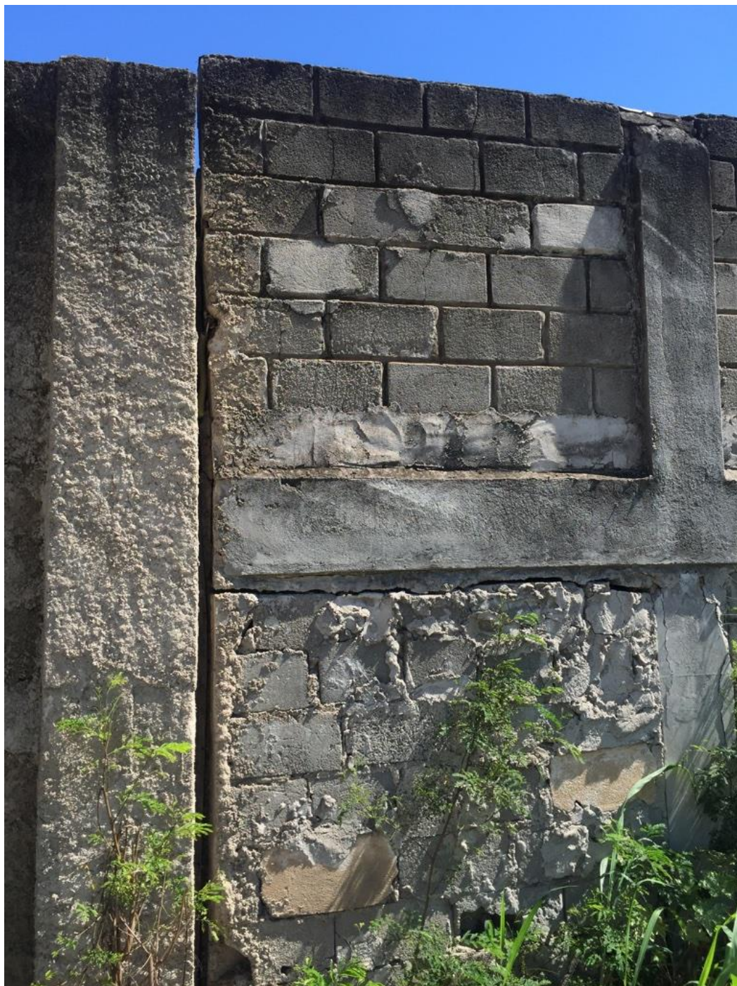
Figura 34 – Prédio Anexo – Parede externa - Descolamento do quadro de alvenaria - Observar que a viga apoia-se parcialmente no pilar
