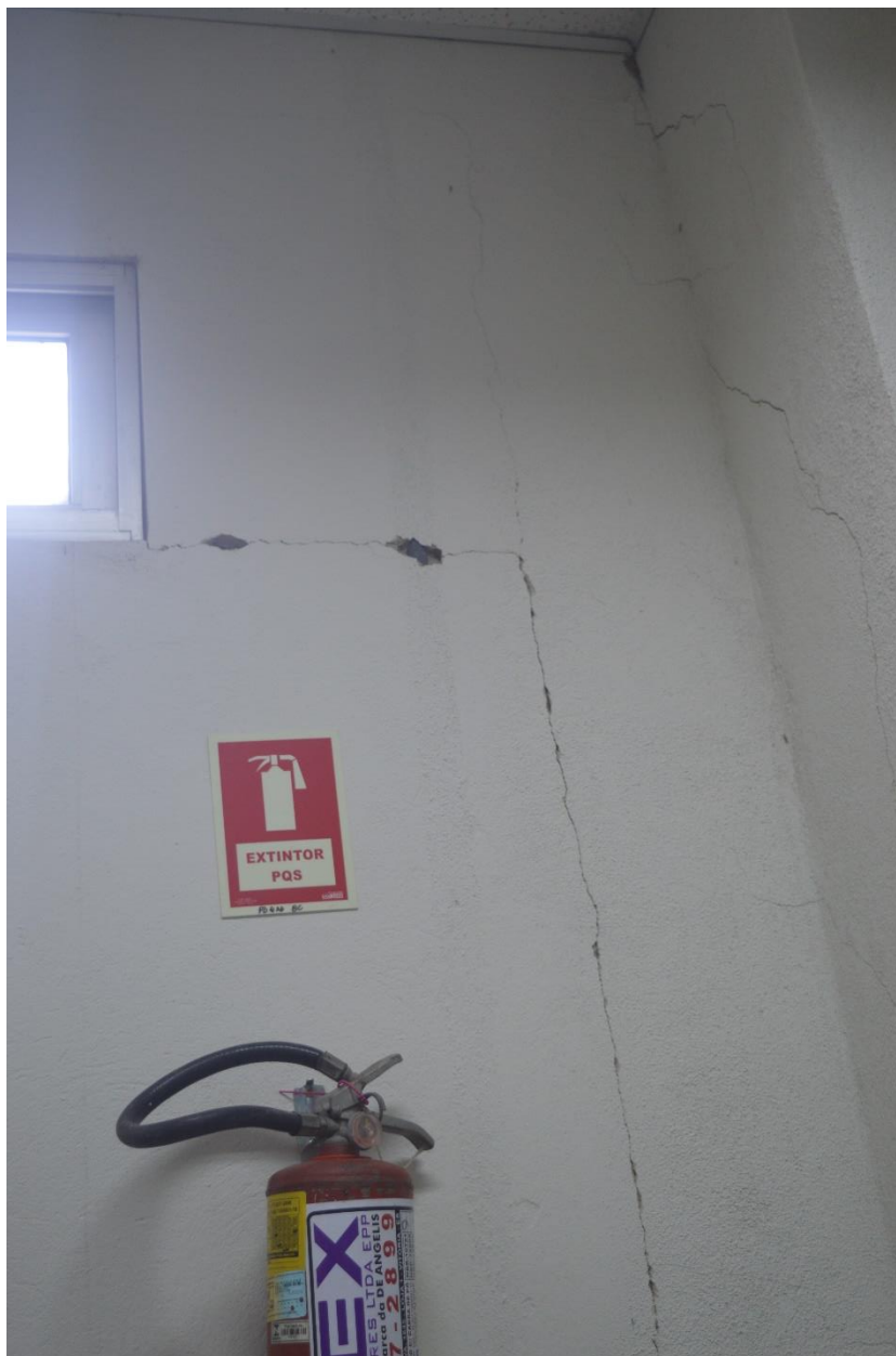
Figura 18 - Depósito Anexo - Trincas horizontal/vertical adjacente a báscula
