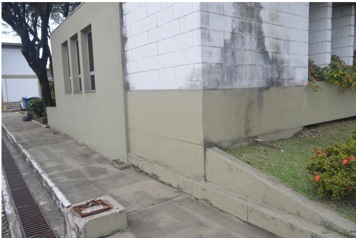
Figura 9 - Ampliação do CPD - Parede Externa – Fachada – Trinca – Descolamento da estrutura inferior assente sobre solo.
