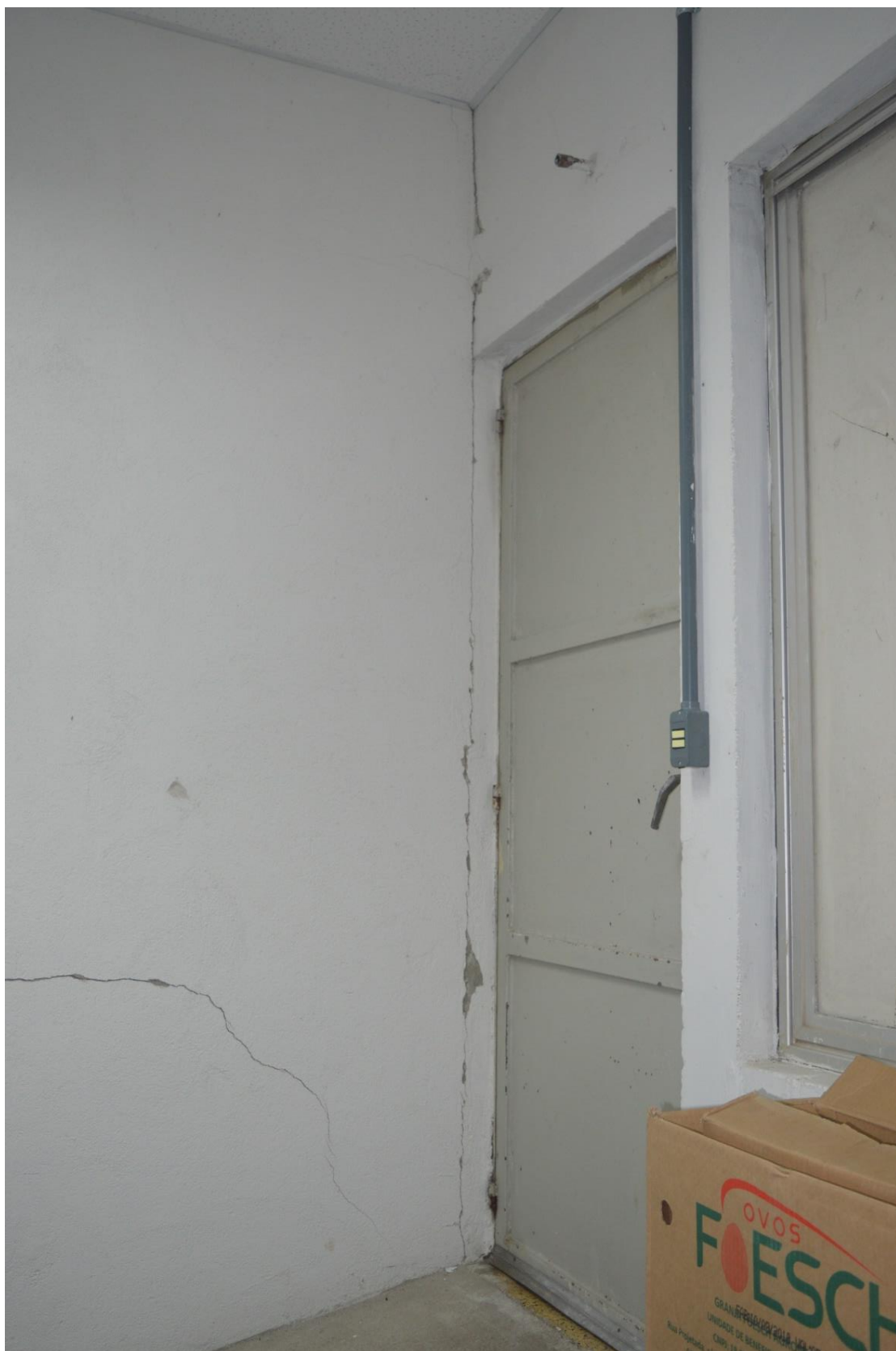
Figura 20 - Depósito Anexo - Trincas e fissuras –Trincas inclinadas e trinca na interface entre a alvenaria nova e existente.
