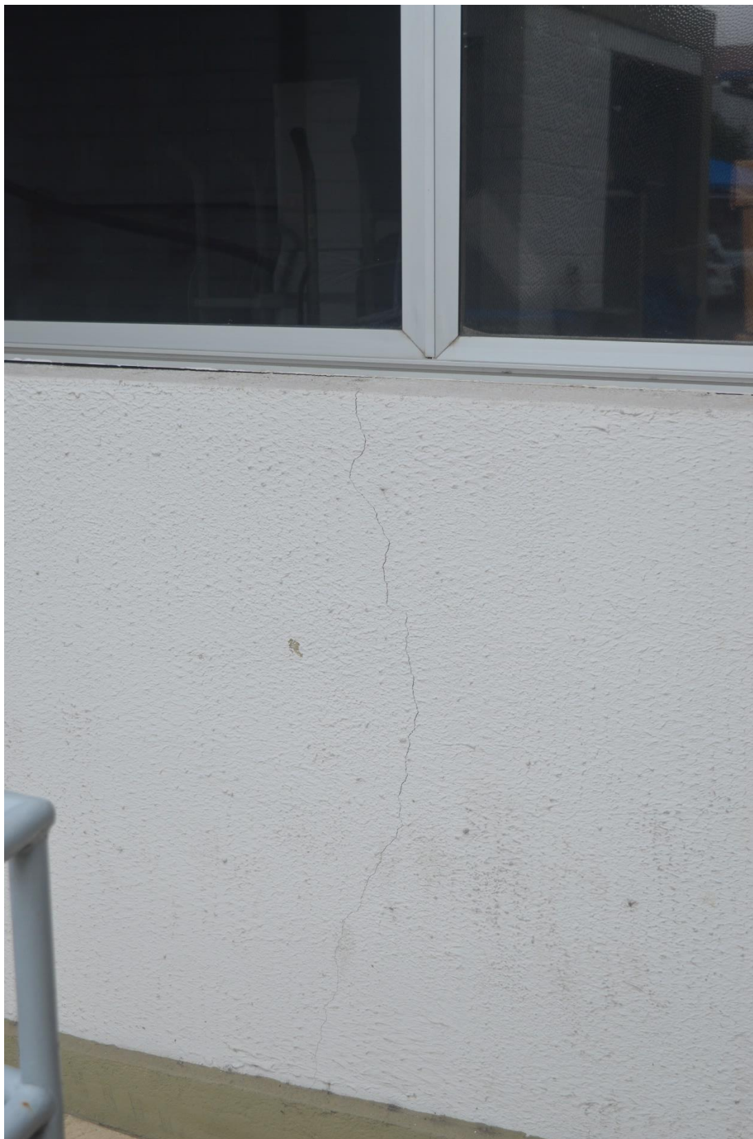
Figura 28 - Prédio Anexo - Parede da Fachada - Trinca da alvenaria 001
