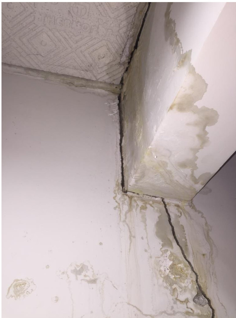
Figura 2 - Ruptura da alvenaria e infiltrações – Alvenaria nova com recorte no perímetro da viga existente.
