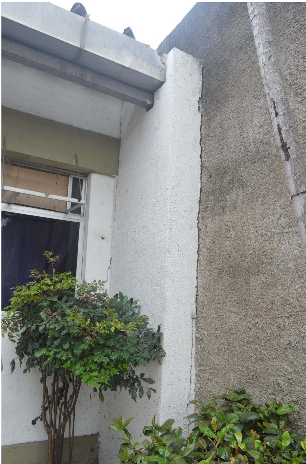
Figura 26 - Prédio Anexo - Parede Externa – Descolamento da Parede – Ausência de estrutura
