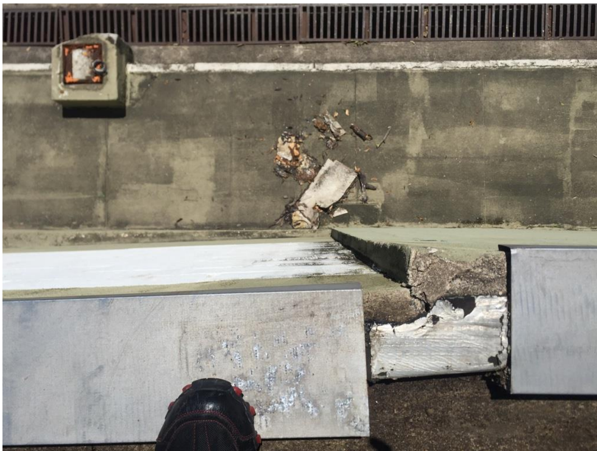
Figura 11 - Falha/Ausência de Chapim na interface entre a estrutura nova e a existente ocasionando as infiltrações.
