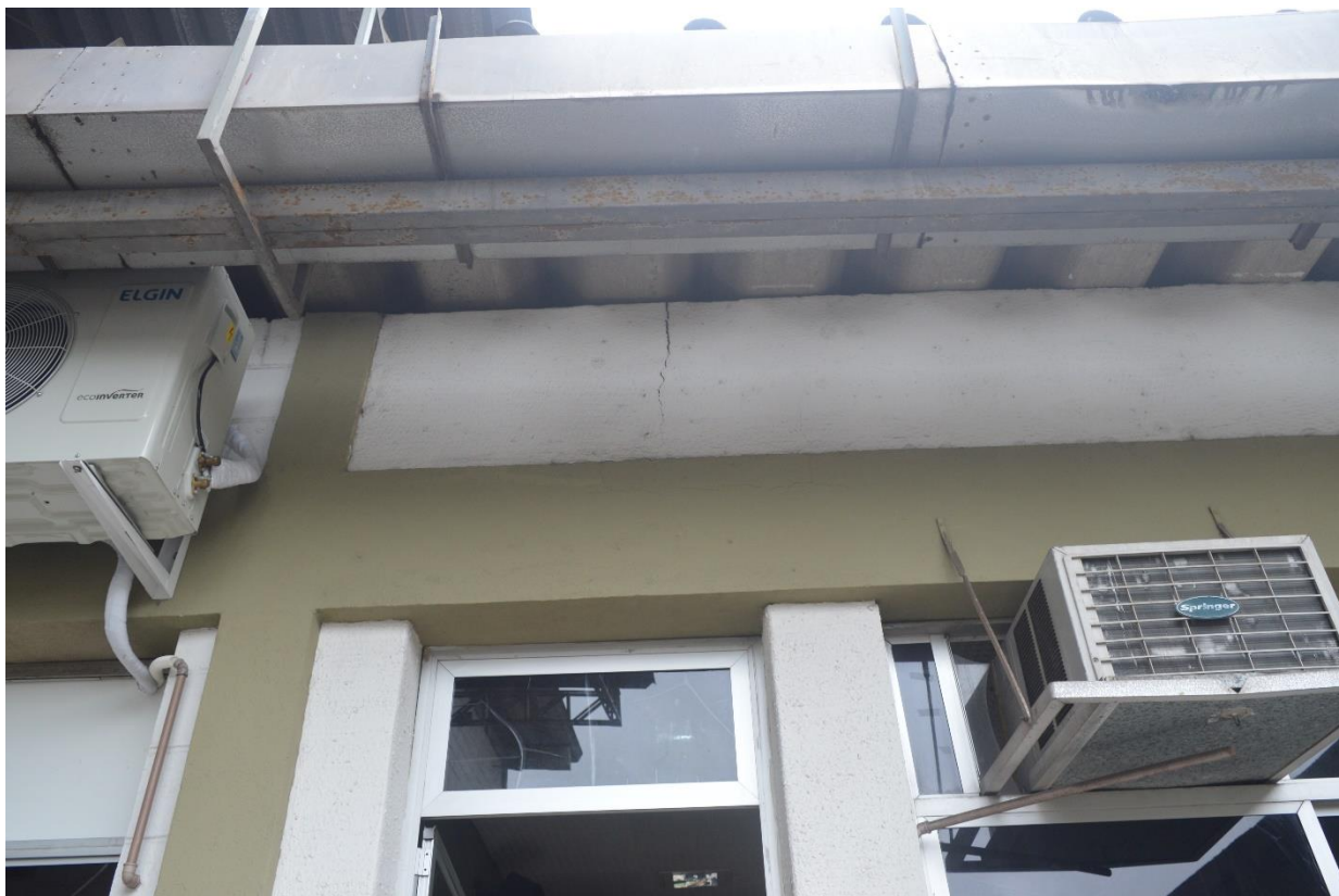
Figura 30 - Prédio Anexo - Parede da Fachada - Trinca da alvenaria 003
