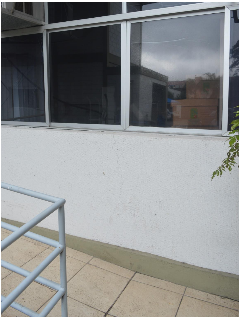
Figura 32 - Fissura Vertical na alvenaria da fachada
