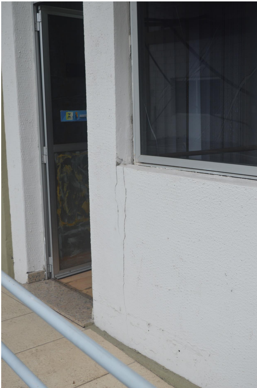
Figura 29 - Prédio Anexo - Parede da Fachada - Trinca da alvenaria 002
