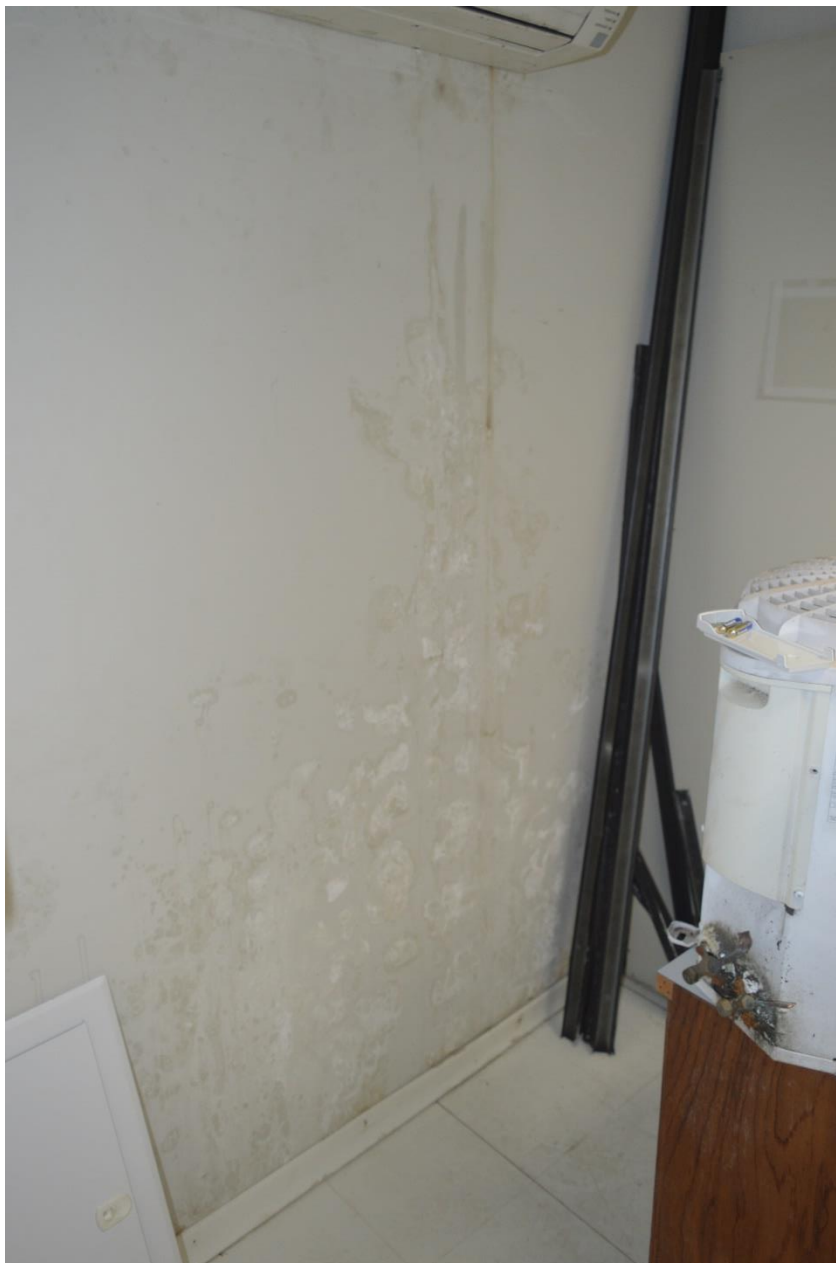
Figura 7 – Ampliação da CPD - Infiltrações da parede Externa
