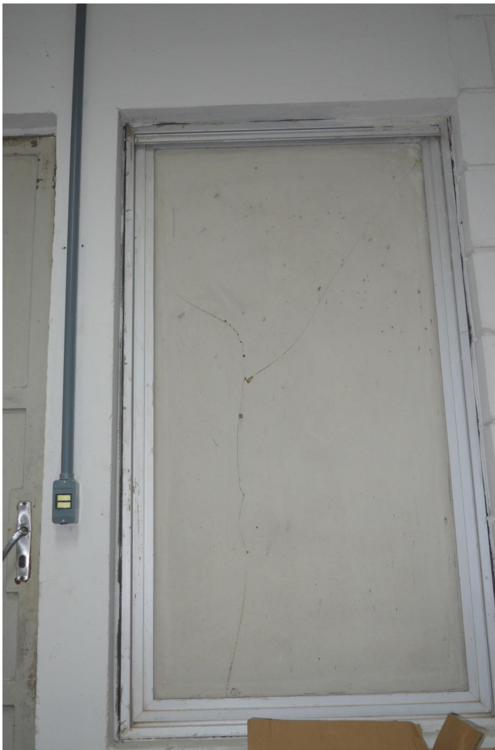
Figura 21 - Depósito Anexo - Trinca no vidro da janela – Janela e Porta Empenadas.
