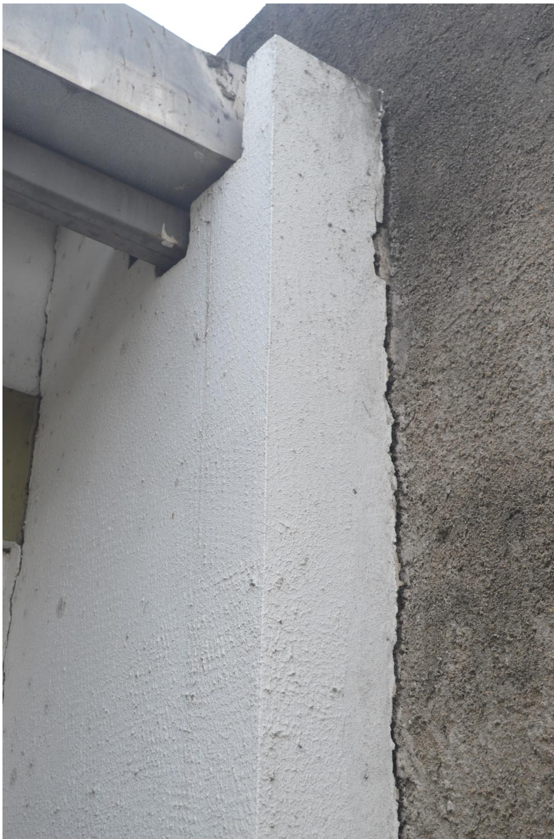
Figura 27 - Prédio Anexo - Parede Externa – Descolamento da Parede - Detalhe Ampliado
