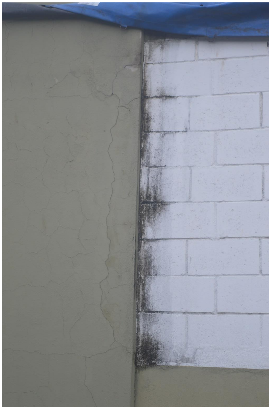
Figura 10 - Ampliação do CPD - Parede Externa Fachada Lateral – Infiltrações e Fissuras – Falha/Ausência de junta de dilatação entre alvenaria nova e existente.
