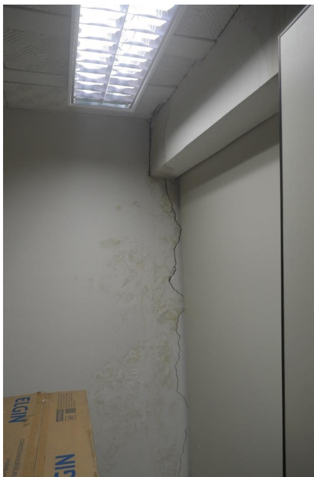
Figura 1 - Ampliação do CPD - Parede Externa – Fachada – Trinca Vertical na Alvenaria - Infiltração
