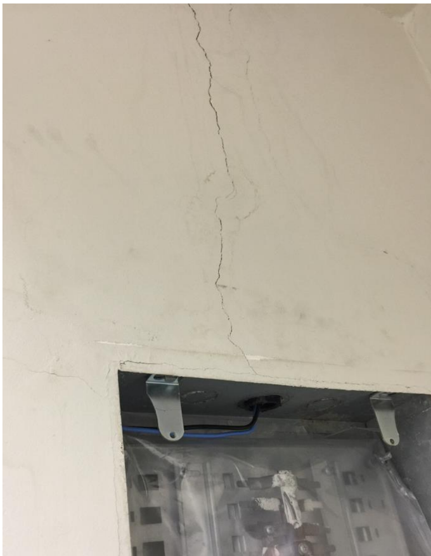
Figura 16 - Fissura na alvenaria na direção do rasgo para instalação de eletroduto.
