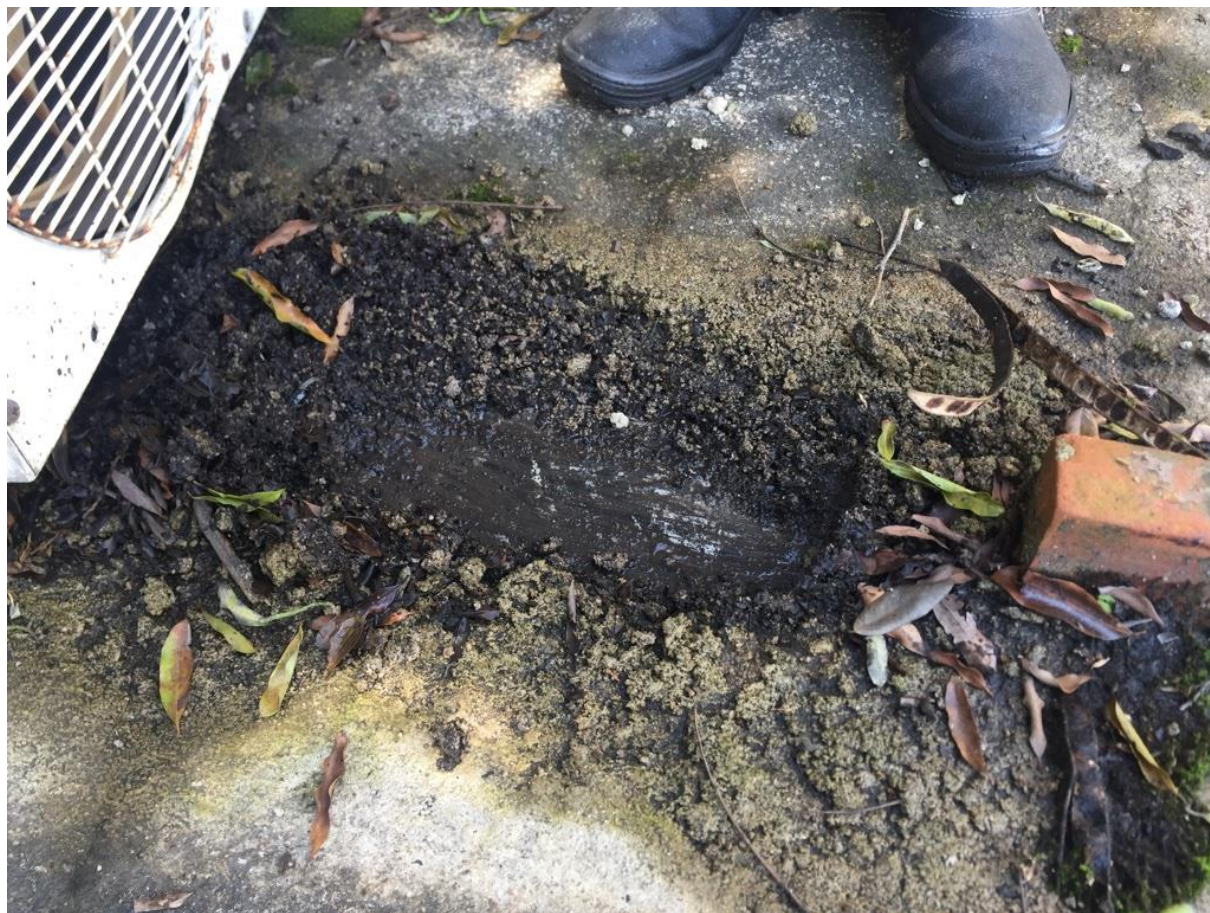
Figura 14 - Segregação da argamassa da proteção mecânica
