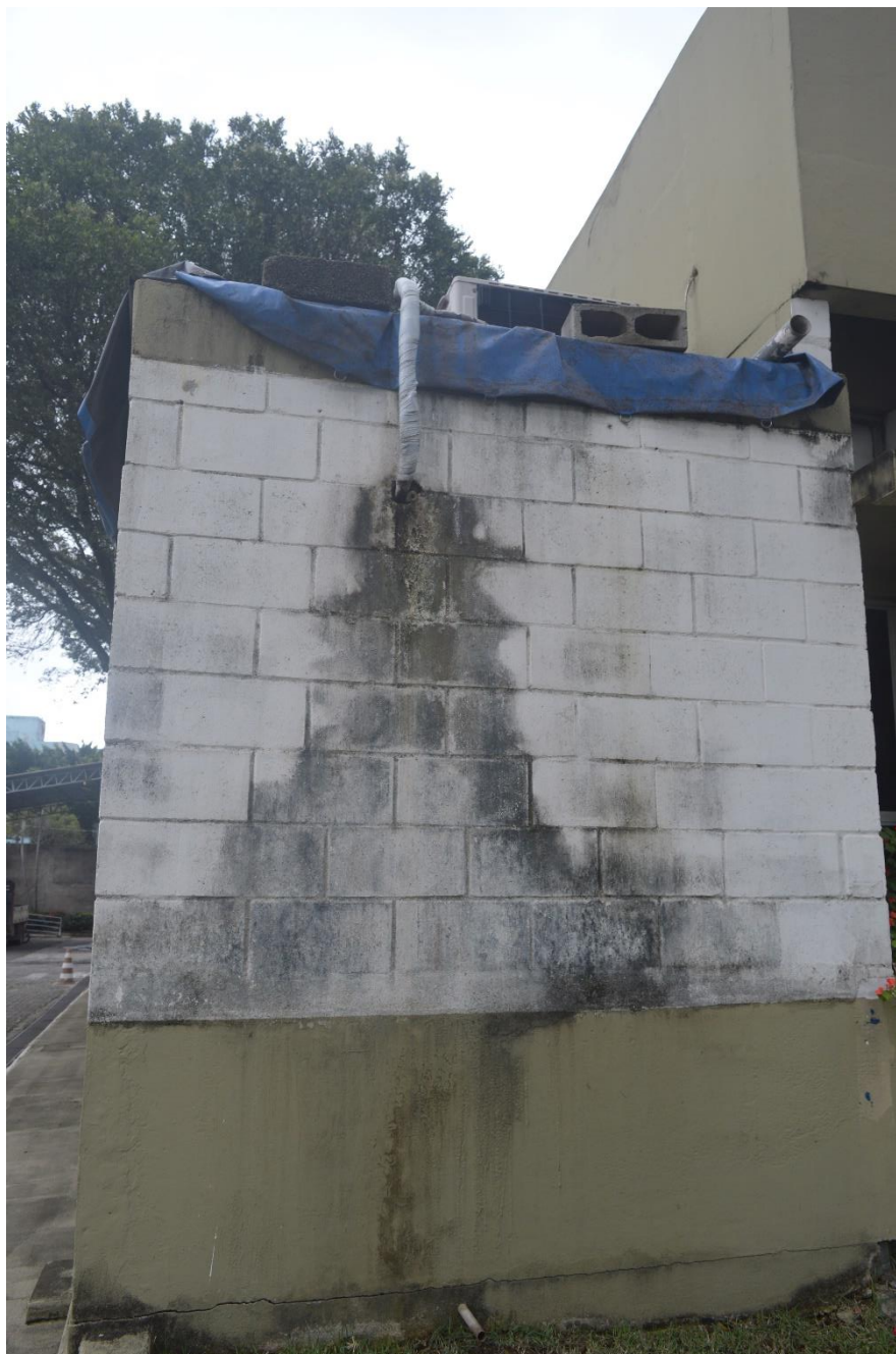
Figura 8 - Ampliação do CPD - Parede da Fachada – Infiltrações da Parede Externa – Dreno do Ar-Condicionado incorretamente instalação.
