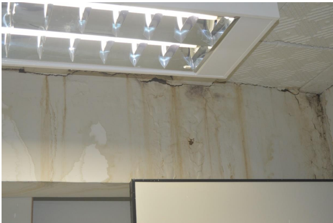
Figura 3 - Ampliação do CPD - Viga Existente – Infiltrações – Trincas no encontro da laje nova com a viga/laje existente
