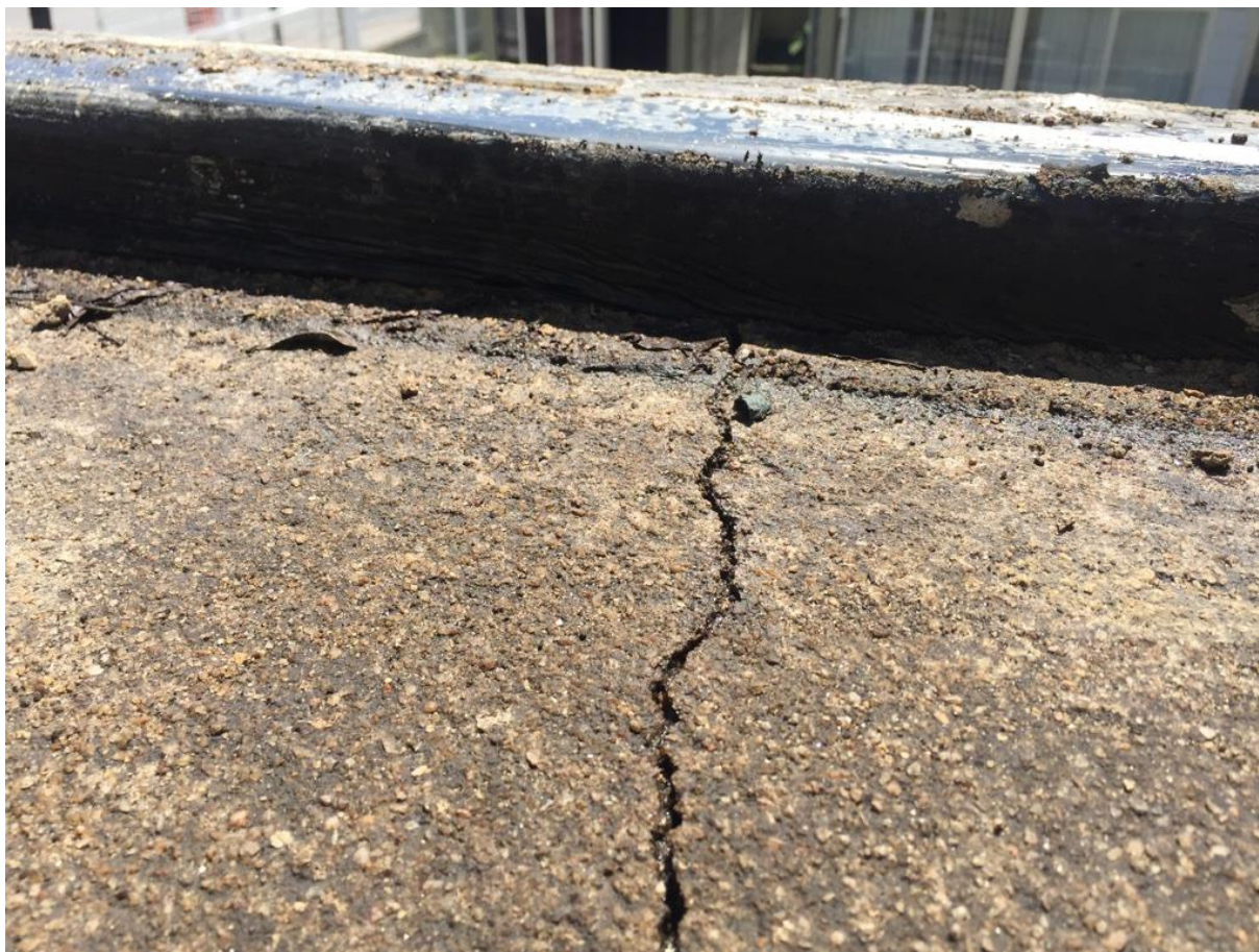
Figura 13 - Trinca na proteção mecânica da laje de cobertura – Ponto de infiltração
