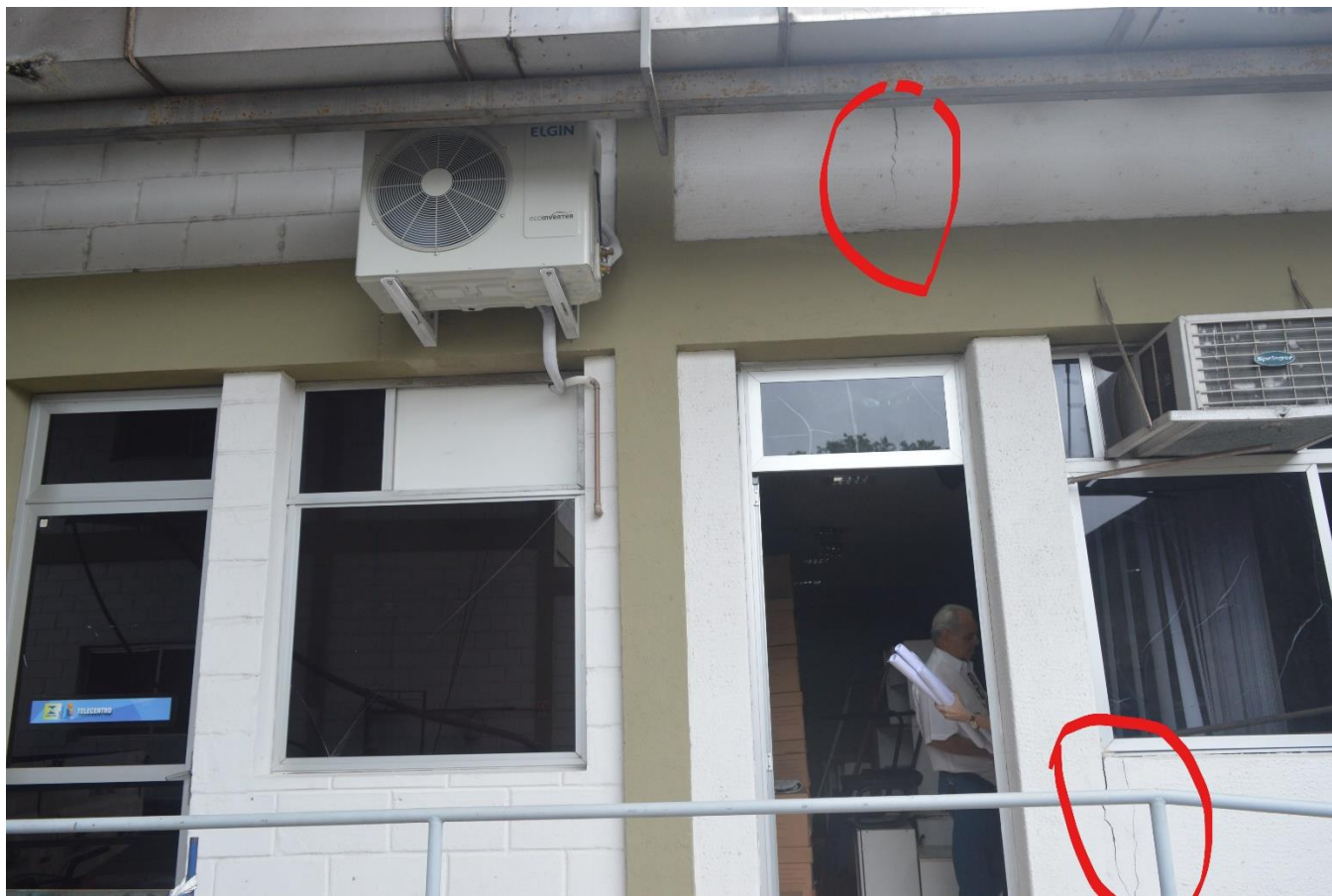
Figura 31 - Prédio Anexo - Parede da Fachada – Visão Ampla – Trincas conjuntas da alvenaria
