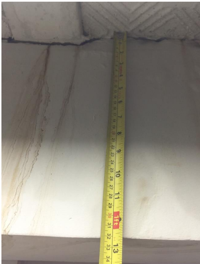
Figura 4 - Altura da viga V16 do Projeto estrutural pav. Cobertura no local
